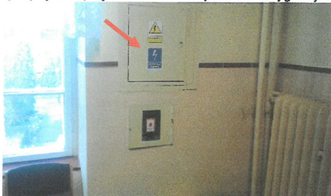
Lokalizacja głównego wyłącznika prądu- wejście W1, klatka K1 piętro
