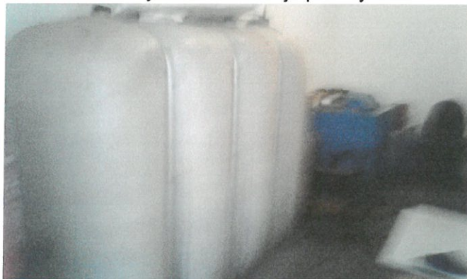
Kotłownia z piecem na olej opałowy-parter od zaplecza.
