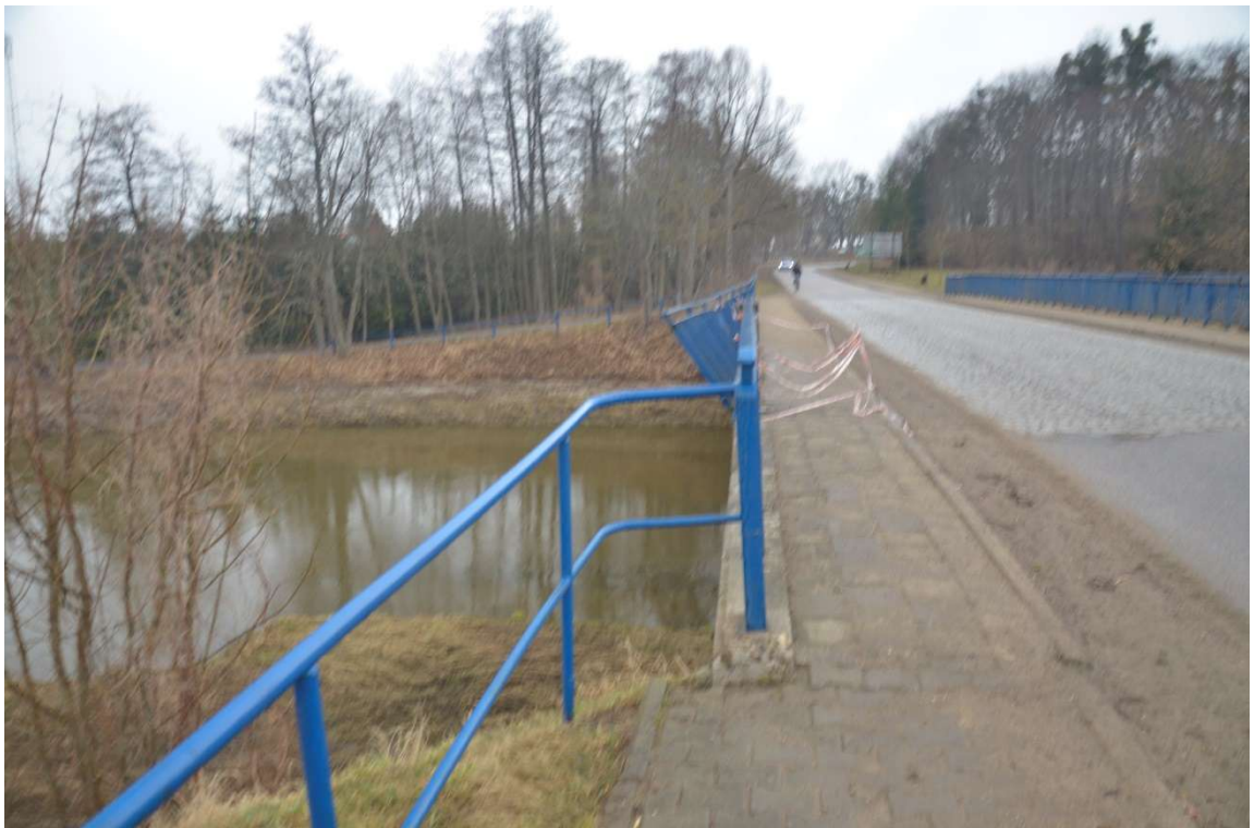
Fot. 2. Widok wyrwanej i wychylonej balustrady.
