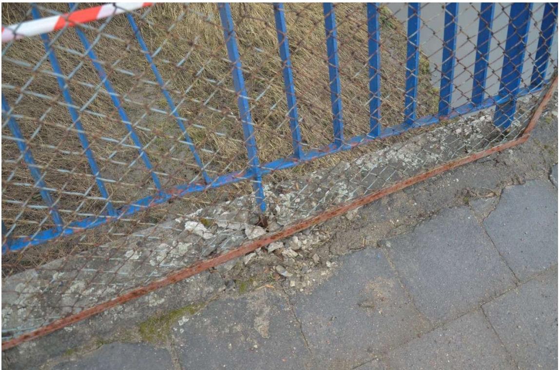
Fot. 4. Widok poluzowanego słupka. Widoczne korozja betonu i dolnej części słupka.
