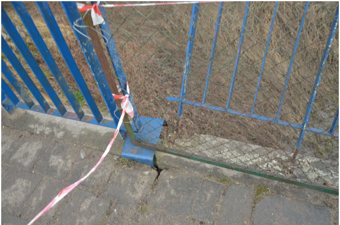
Fot. 3. Widok wyrwanego słupka balustrady. Widoczna korozja dolnej części słupka.
