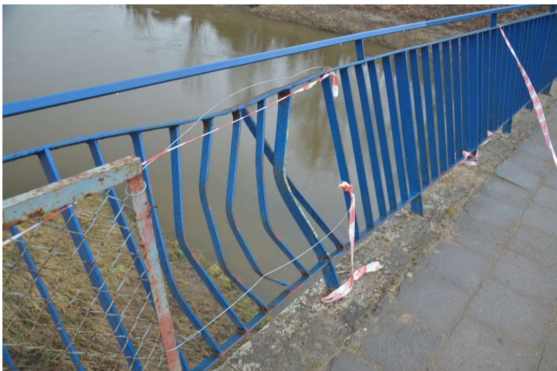
Fot. 5. Widok zdeformowanych elementów balustrady.
