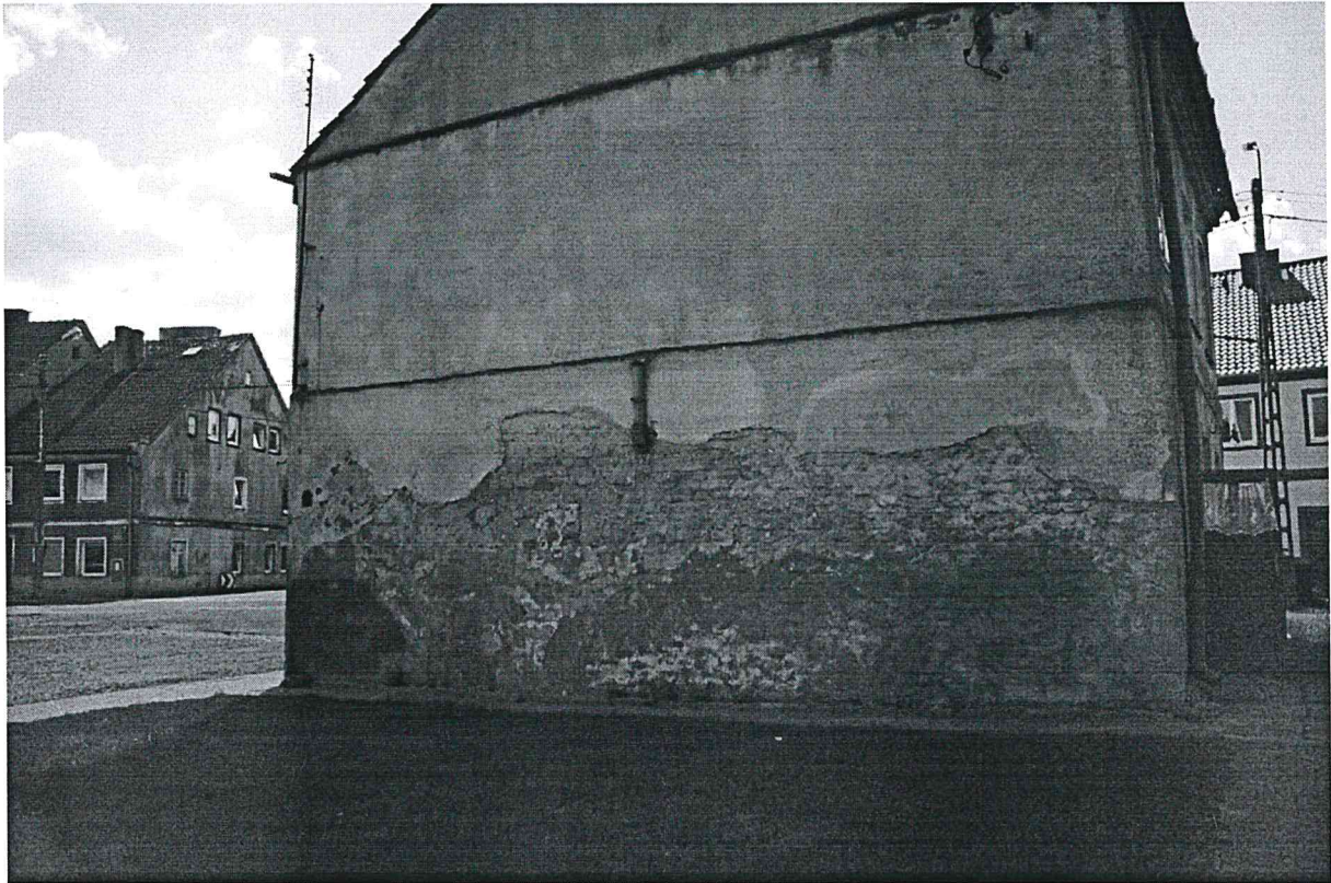
Fot. 7 Skutki działania wilgoci
