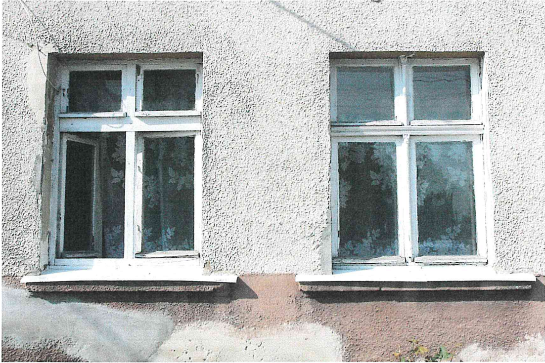
Okna na parterze elewacji frontowej. Z lewej strony wtórne, a z prawej oryginalne.
