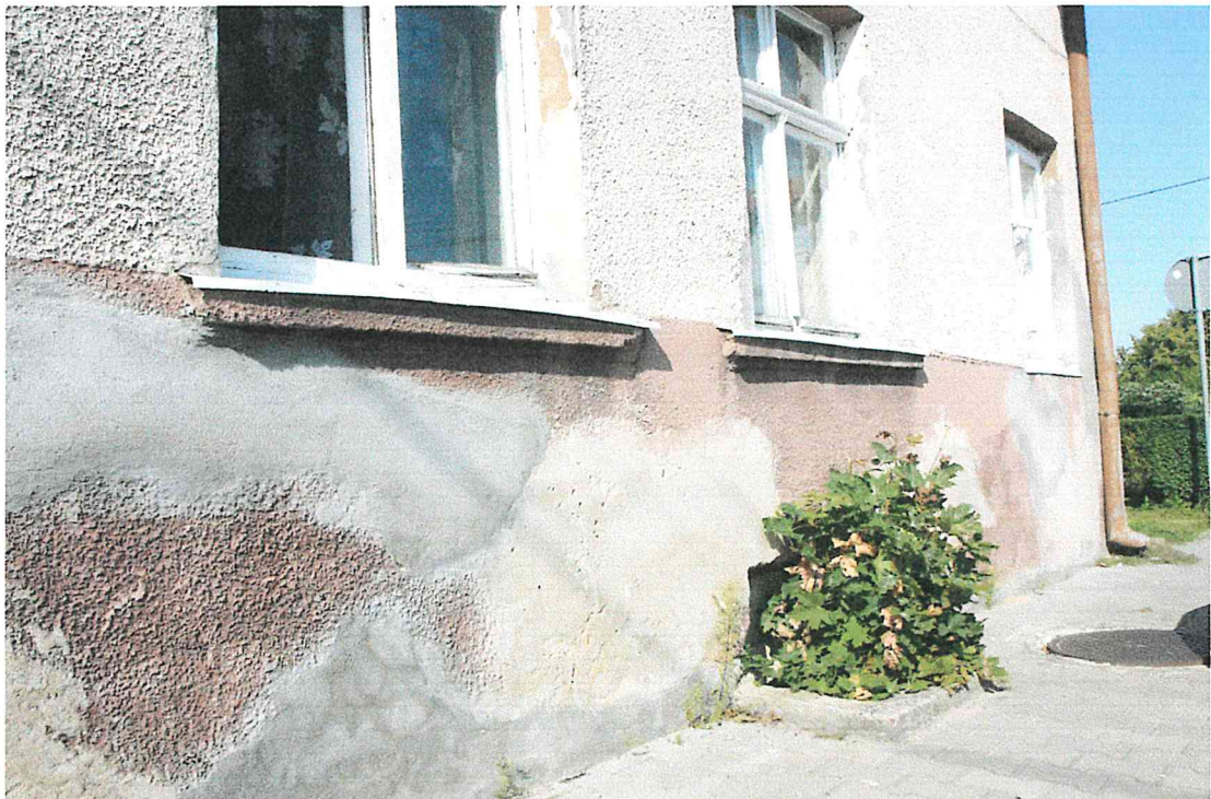
W przeszłości, przy okazji wymiany tynku usunięto z elewacji wiele detali. Zachowały się dwa profilowane gzymsy podokienne.
