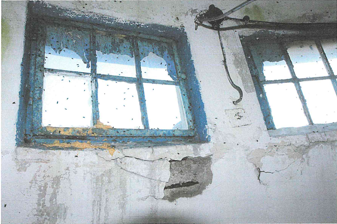
Fragmenty tynku odpadają ze ścian odsłaniając skorodowane zbrojenie.
