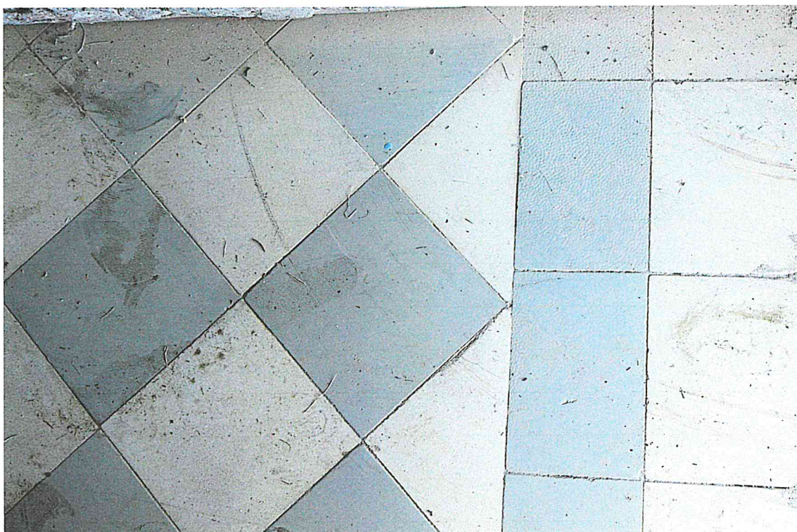
Fragment oryginalnej , ceramicznej posadzki. Początkowo kafle miały groszkową fakturę (tak jak ciemny, prostokątny znajdujący się wyżej). Z czasem powierzchnie uległy wygładzeniu.
